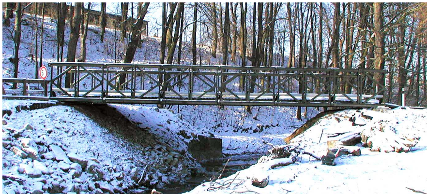
Obr. č. 4.7 Mostní konstrukce uložená na narušeném břehu
