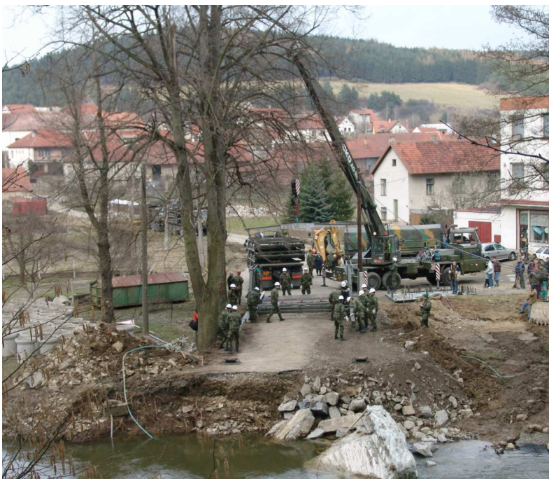
Obr. č. 5.5 Komplikace na staveništi způsobené stromy a nadzemním vedením
