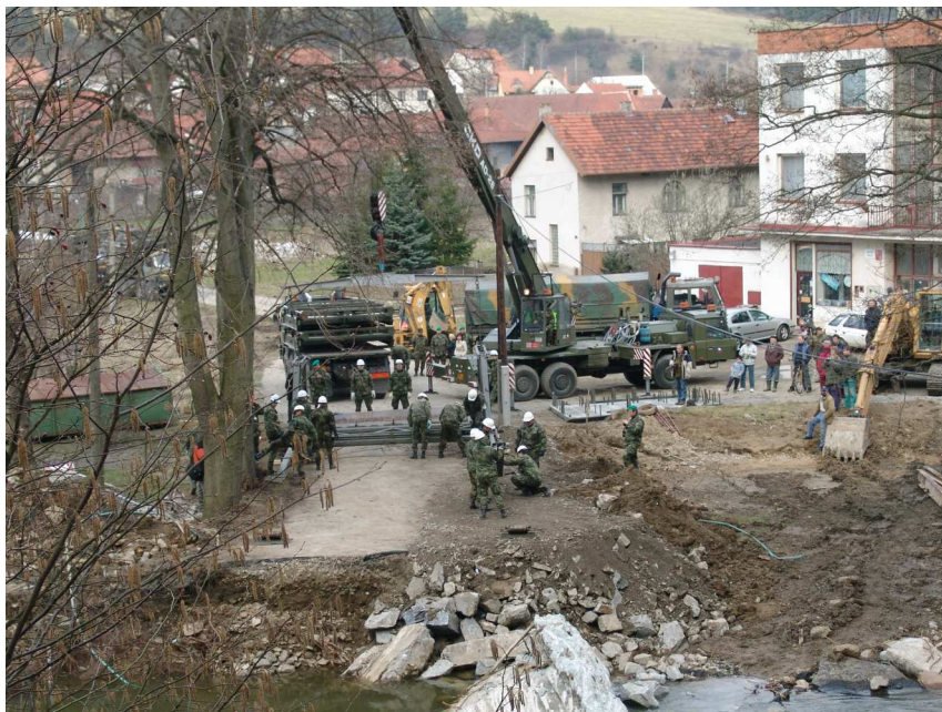
Obr. č. 5.1 Nadzemní vedení a vzrostlé stromy v obci Číchov omezující práci jeřábu
