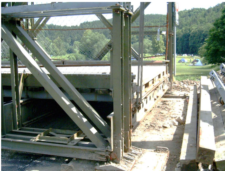
Obr. č. 5.25 Odstraněné nájezdy na most
