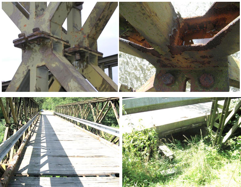
Obr. 6.2 Zanedbaná údržba na mostě TMS, povolené spoje příhrad, koroze
