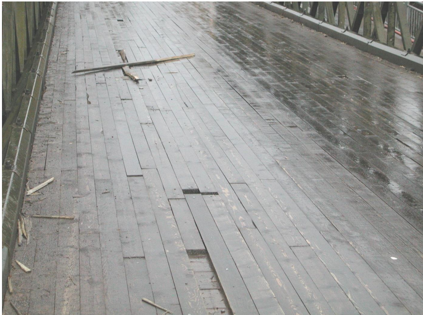
Obr. 6.5 Vozovka poškozená vlivem intenzivní dopravy
