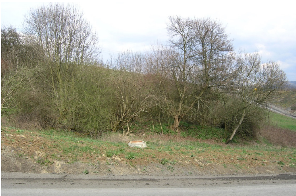
Dokumentační bod č. 8: čelo akumulace sesuvu v jeho spodní části (patrný stupeň za betonovou skruží, pohled na V, foto J. Klimeš, duben 2016).
