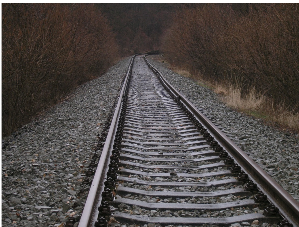
Dokumentační bod č. 2: ukazuje deformaci koleje na úseku trati Úpořiny - Chotiměř v JV části sesuvu – pohled na JV (foto J. Klimeš, březen 2016).
