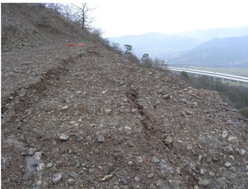
Dokumentační bod č. 4: detail dvou nad sebou vzniklých, nízkých odlučných stěn (pohled na SV, foto J. Klimeš, březen 2016)).
