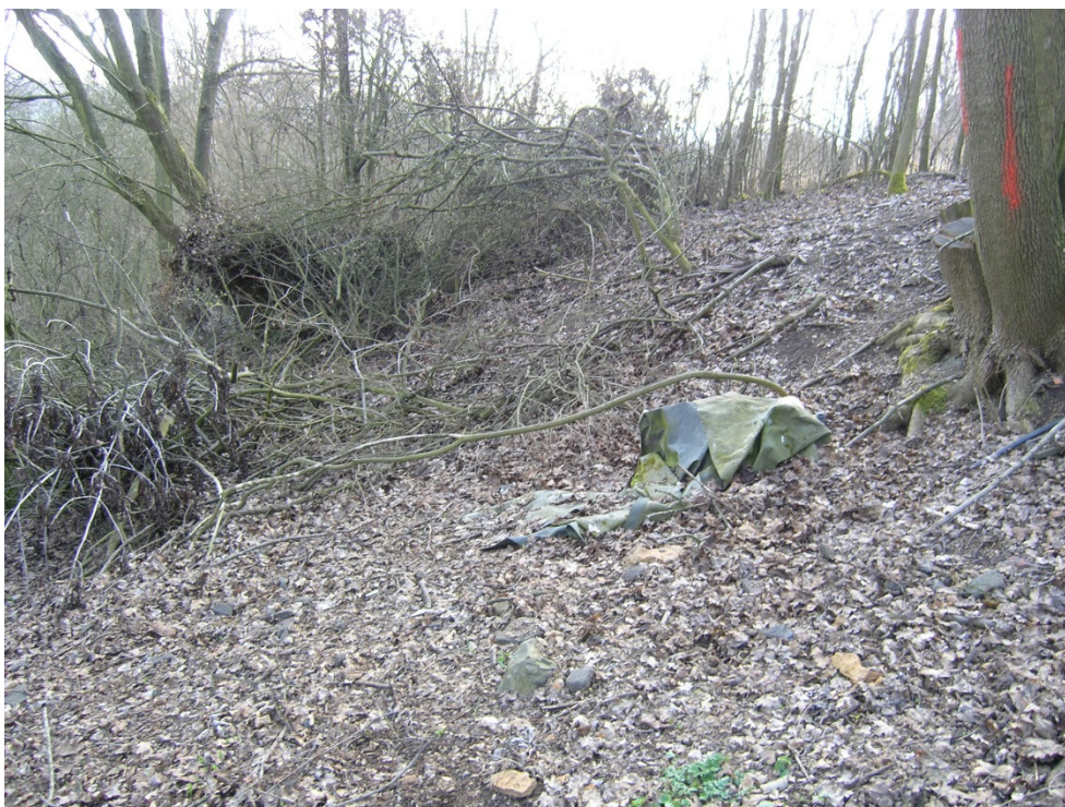
Dokumentační bod č. 8: nejvýše položená odlučná stěna dočasně uklidněného sesuvu (stupeň se stromem u pravého okraje fotografie, pohled na SZ, foto J. Klimeš, duben 2016).
