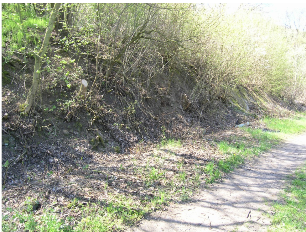
Dokumentační bod č. 18h: čelo akumulace dílčího, dočasně uklidněného sesuvu je místy zapřeno betonovými panely (u pravého okraje fotografie, foto J. Klimeš, duben 2016).
