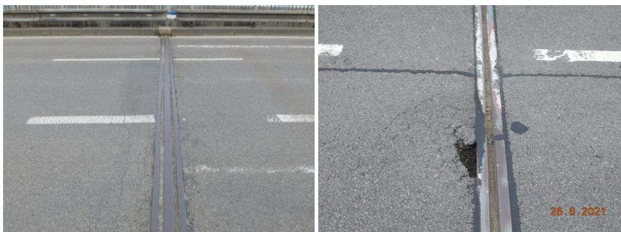
Obrázek 28: Vlevo přechodová oblast zvlněna, viditelné příčné nebo podélné nerovnosti, vpravo u přechodové oblasti výtluky různého rozsahu
