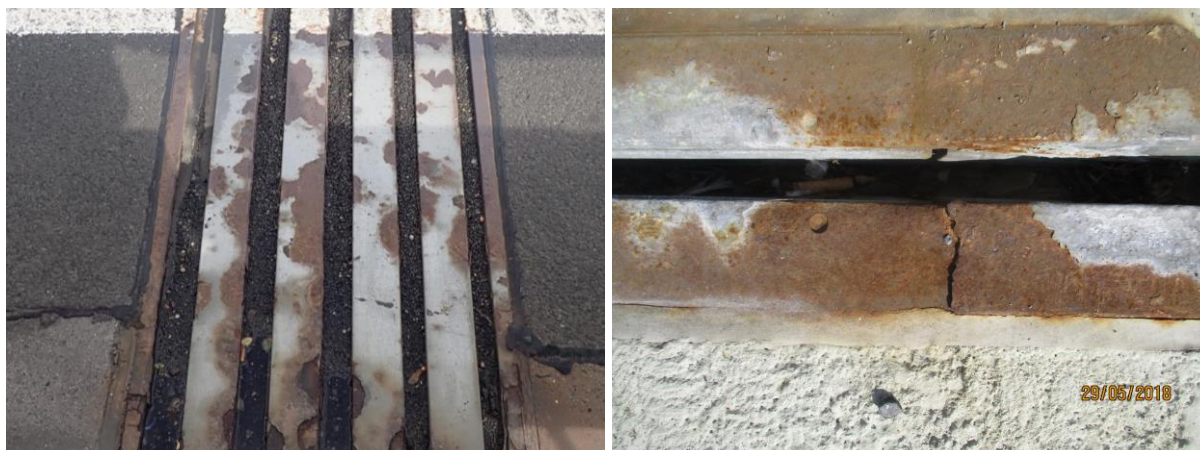
Obrázek 26: Vlevo poškození PKO svislých ploch (odlupování), místy začínající drobná povrchová koroze, vpravo rozsáhlá koroze MZ, prolomení profilů, nerovnoměrné rozevření lamel, deformace profilů apod.
