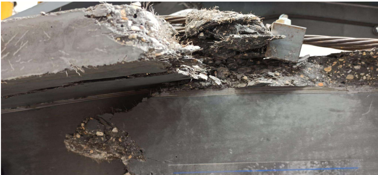
Obr. 36: Poškození tahem a smykem.
