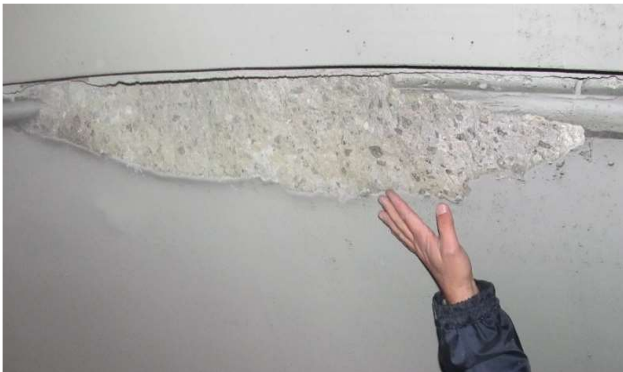
Obr. 4: Foto poruchy sekundárního tunelového ostění.
