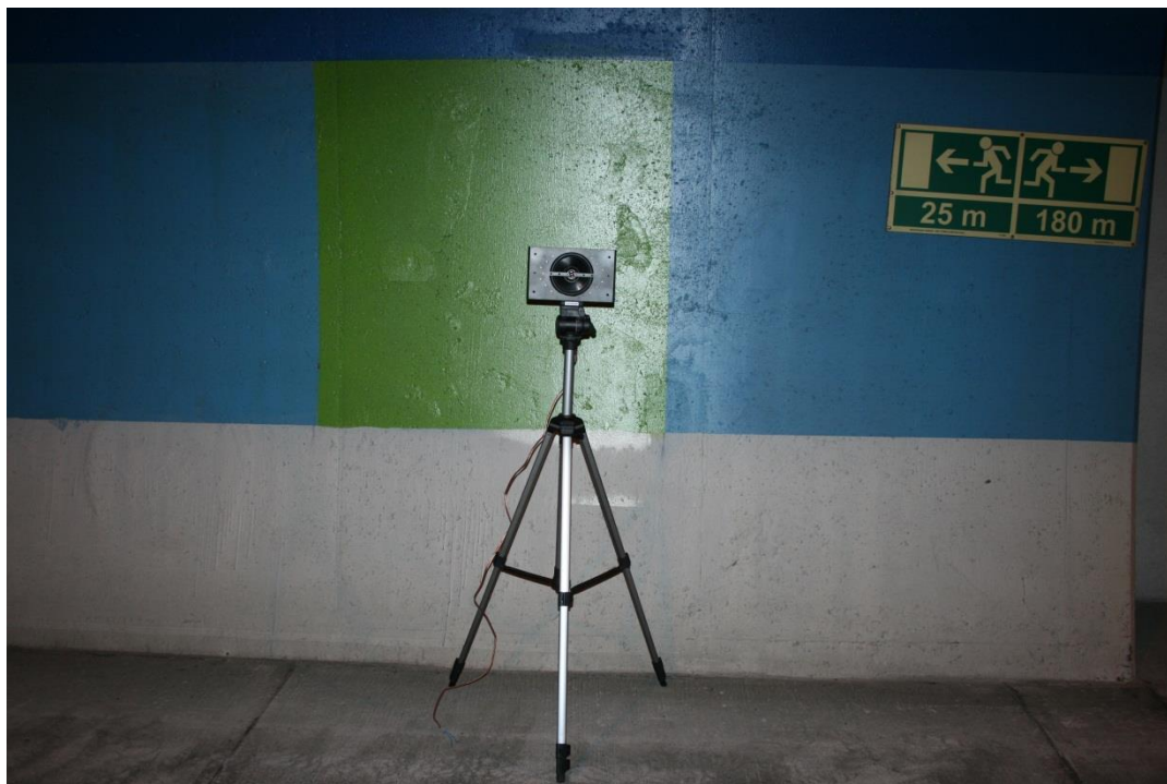
Obr. 15: Elektroakustický prvek nouzového zvukového systému umístěný provizorně na trojnožce v tunelové troubě
