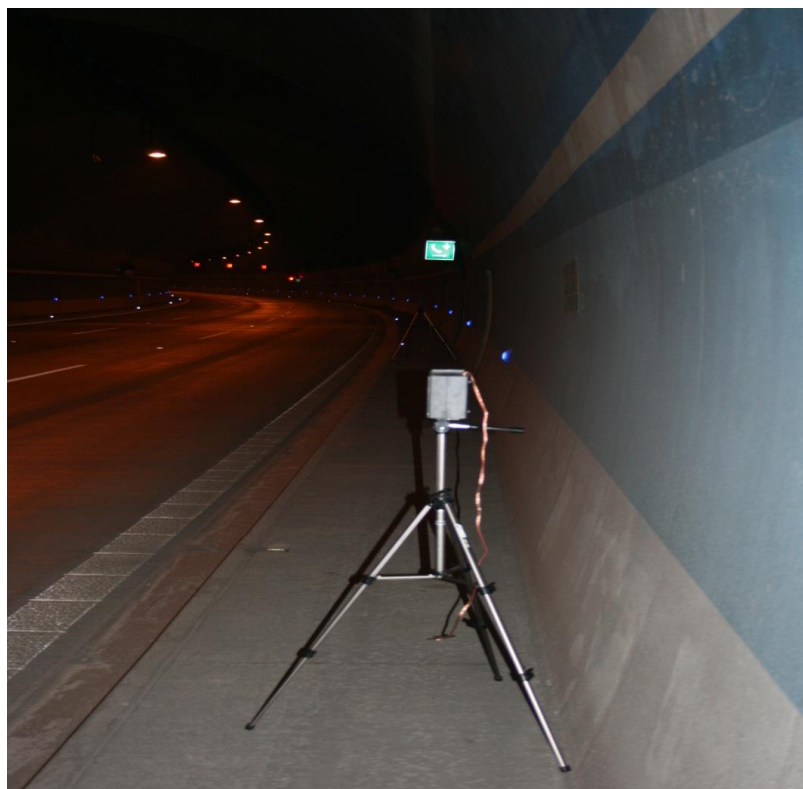
Obr. 16: Elektroakustický prvek nouzového zvukového systému umístěný v tunelové troubě
