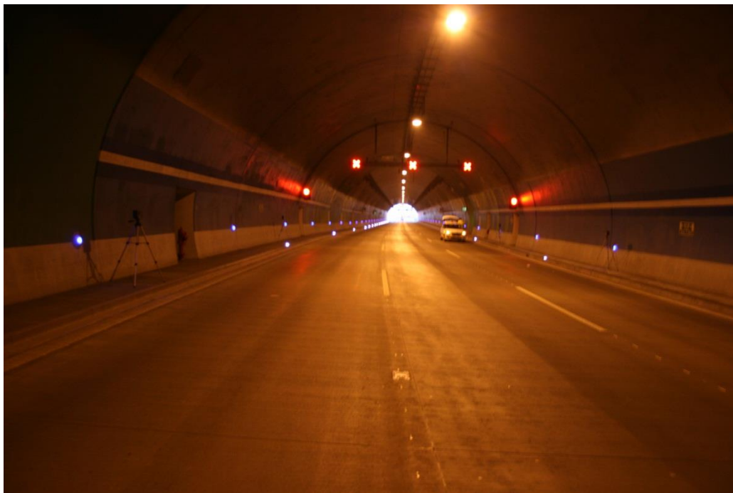
Obr. 17: Tunelová trouba s rozmístěnými prvky nouzového zvukového systému
