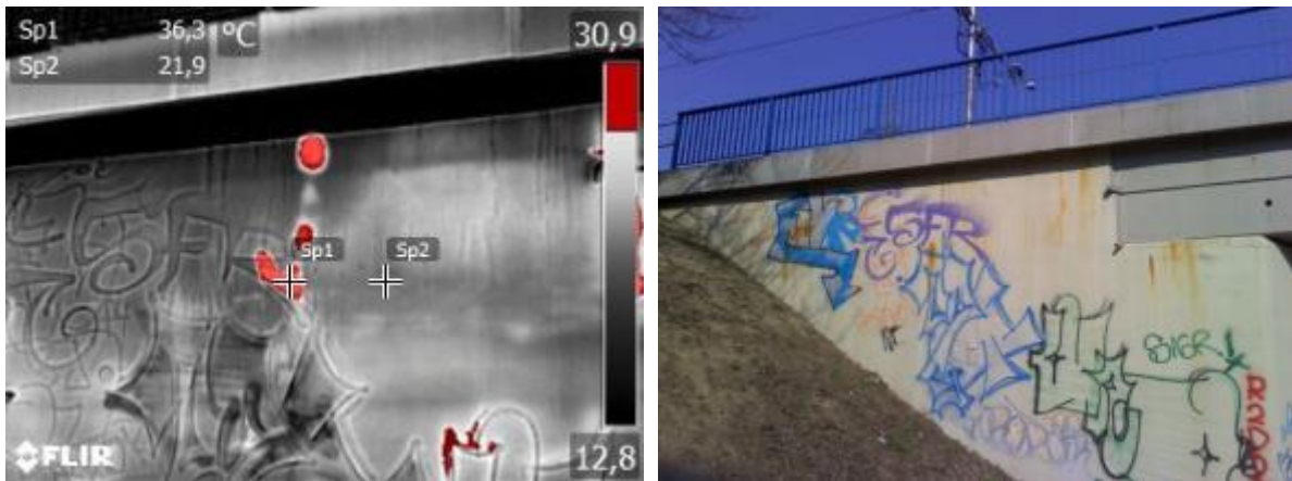
Obr. 6: Sanační nátěr na křídle opěry místy oddělený od podkladu, červená – teplejší barva, zdroj: CDV
