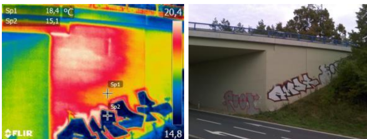
Obr. 4: Vliv posprejovaného povrchu na naměřenou teplotu, zdroj: CDV
