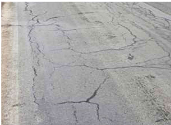
OBRÁZEK 6: Mozaikové trhliny zestárnutých asfaltových vrstev
