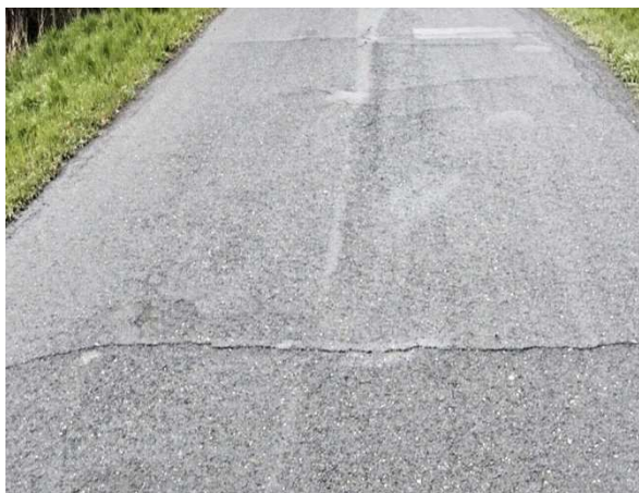
OBRÁZEK 4: Příčné reflexní nebo mrazové trhliny
