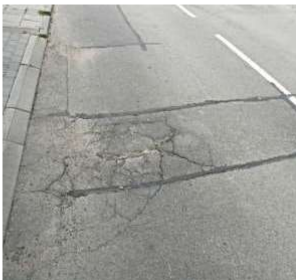
OBRÁZEK 8: Porušené vysprávkování po opravě inženýrských sítí
