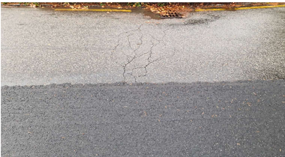
OBRÁZEK 17: Zkušební úsek emulzního mikrokoberce s výztužným geokompozitem - zamezení šíření příčné rozvětvené trhliny (stav 4 měsíce po opravě)
