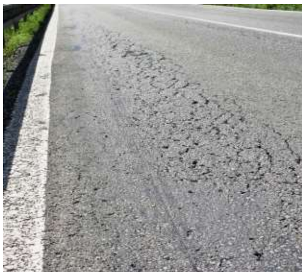
OBRÁZEK 10: Porucha únosnosti okraje vozovky se síťovými trhlinami a poklesem okraje vozovky
