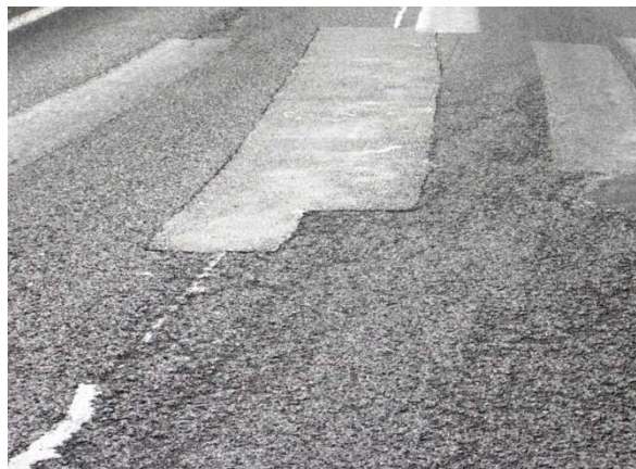
OBRÁZEK 7: Koroze povrchu s lokálními opravami
