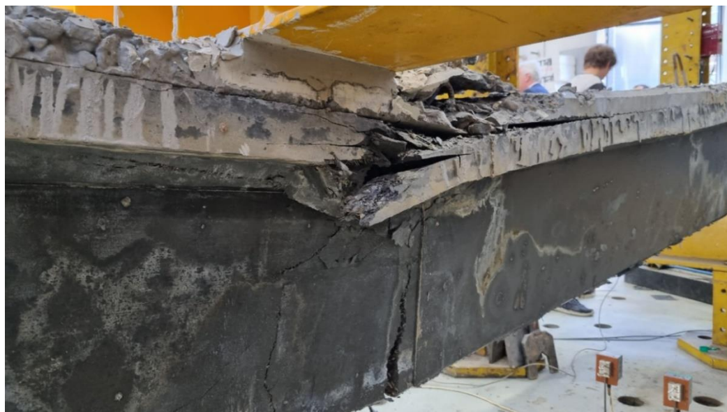
Obr. 11. Porušení nosníku č. 133/2.
