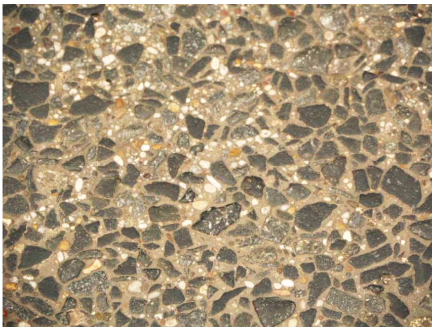
Obrázek 3.1 Detail ohlazeného cementobetonového krytu s nevhodným kamenivem (čedič a křemen)
