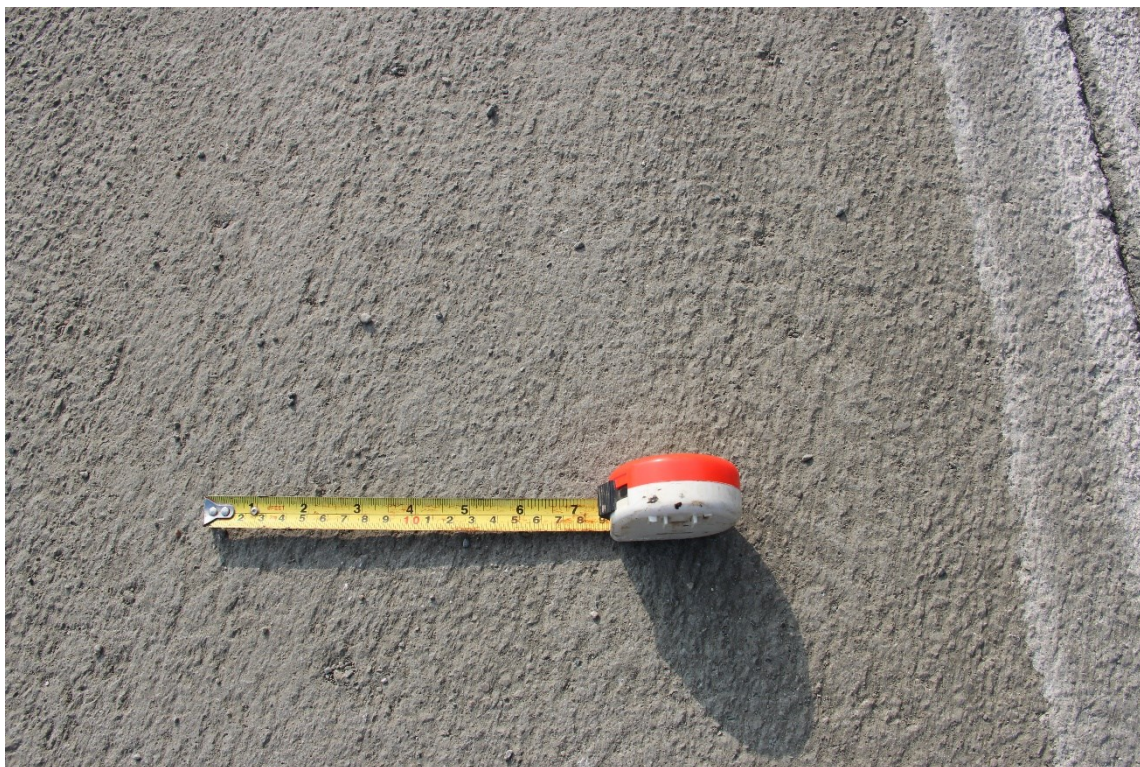
Obrázek 3.6 Povrch cementobetonového krytu s nedostatečně vymetenou cementovou maltou
