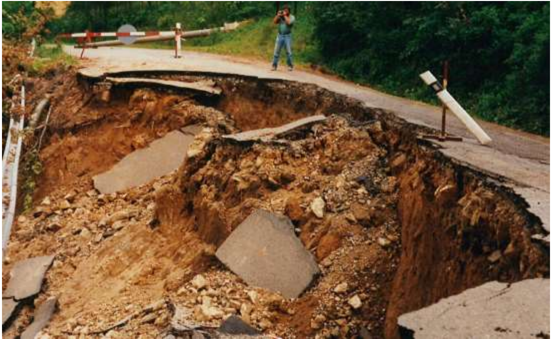
Obr. 4: Kompletně sesuvem zničená pozemní komunikace u přehrady Bystřička v červenci 1997. Foto: Karel Kirchner.
