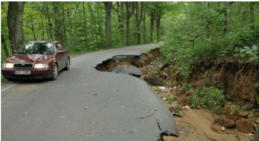
Obr. 3: Komunikace poničená erozní činností při povodních v roce 2010. Nouzově byl tento úsek průjezdný. Foto: KÚ Libereckého kraje.
