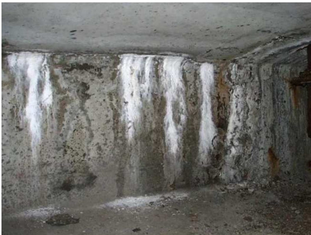
Obr. 3 Viditelné bílé výluhy a povlaky po zatékání uvnitř komory předpjatého mostu. Příčina zatékání – nefunkční hydroizolační systém a nevhodně vyřešená pracovní spára.
