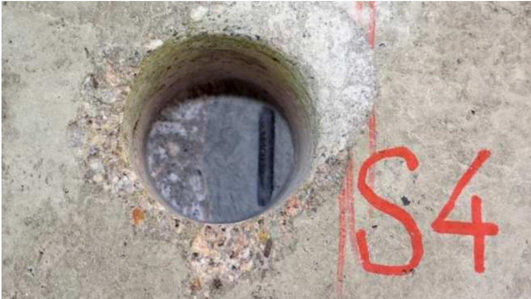
Obr. 17 Detail sondy S4 (viz. Obr. 16). Viditelná kompaktní injektáž a předpínací drát bez koroze.
