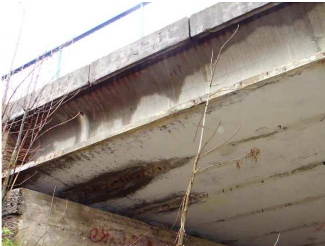
Obr. 1 Viditelné stopy po zatékání (tmavé skvrny) na povrchu betonu předpjatého tyčového prefabrikátu typu I (nejčastěji I-67, I-73). Zatékání se nejčastěji objevuje na povrchu betonu pod mostními římsami nebo v prostoru uložení prefabrikátu (zatékání skrze mostní závěry).
