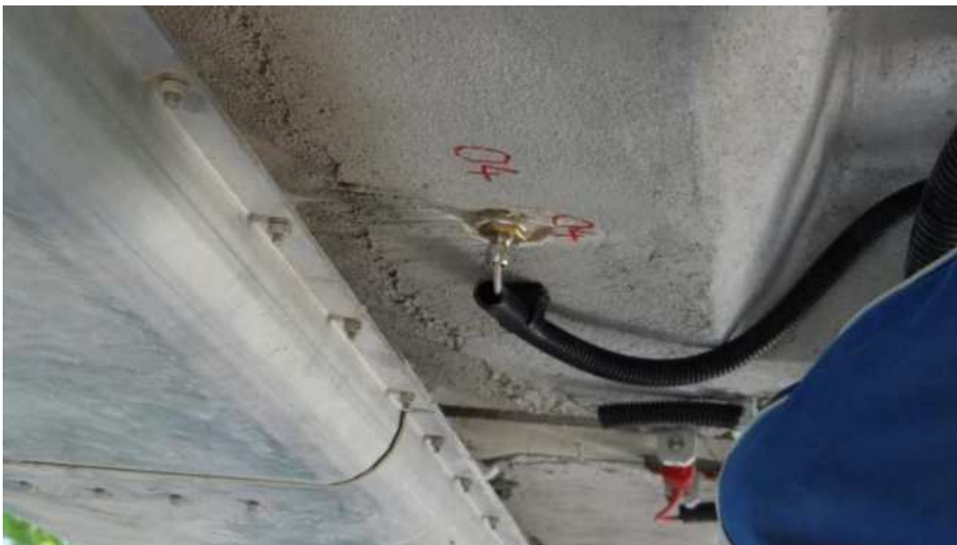
Obr. 166 Pouzdro s osazeným snímačem vlhkosti zapojeným do online monitoringu
