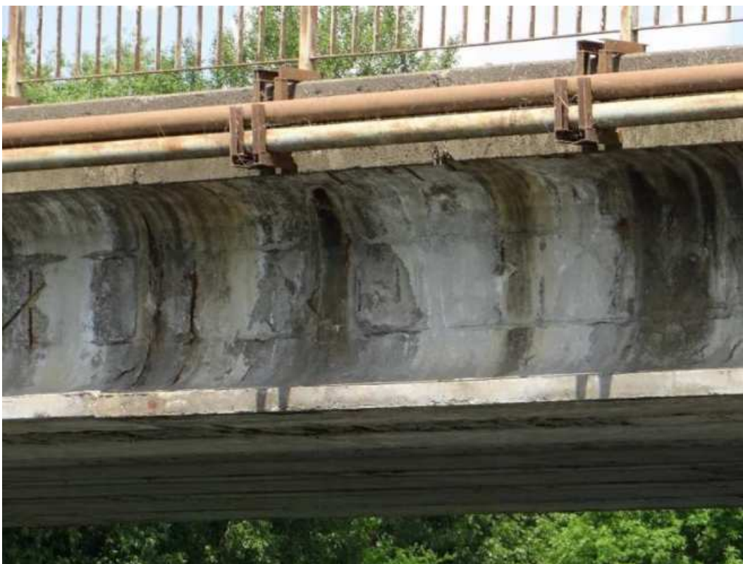
Obr. 2 Viditelné bílé povlaky a výluhy na povrchu betonu v místech stékání vody. Na obrázku jsou zobrazeny typické bílé mapy na povrchu tyčových předpjatých prefabrikátů typu I (nejčastěji I-67, I-73).
