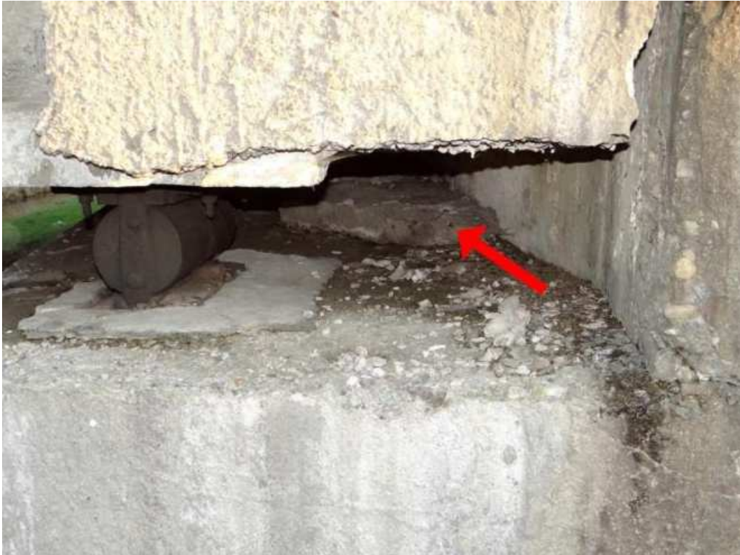
Obr. 42 Pohled na úložný práh mostu s odpadanou dobetonávkou kotevní oblasti.
