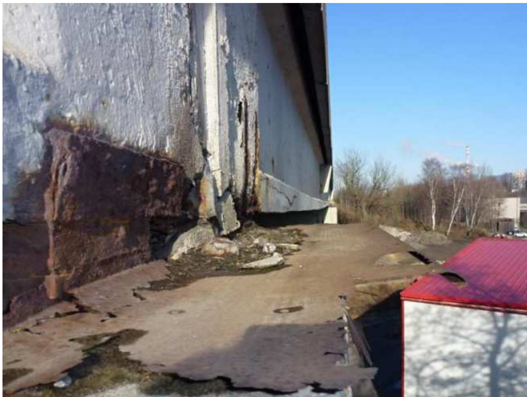
Obr. 40 Průhyb mostu složeného z předpjatých nosníků.
