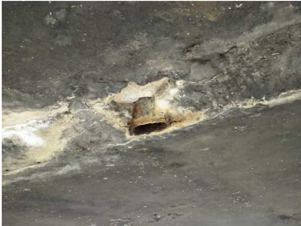
Obr. 14 Zatékání v okolí trubního odvodnění nosné konstrukce v podélné spáře mezi prefabrikovanými tyčovými nosníky, které je doprovázeno tvorbou povlaků a výluhy.
