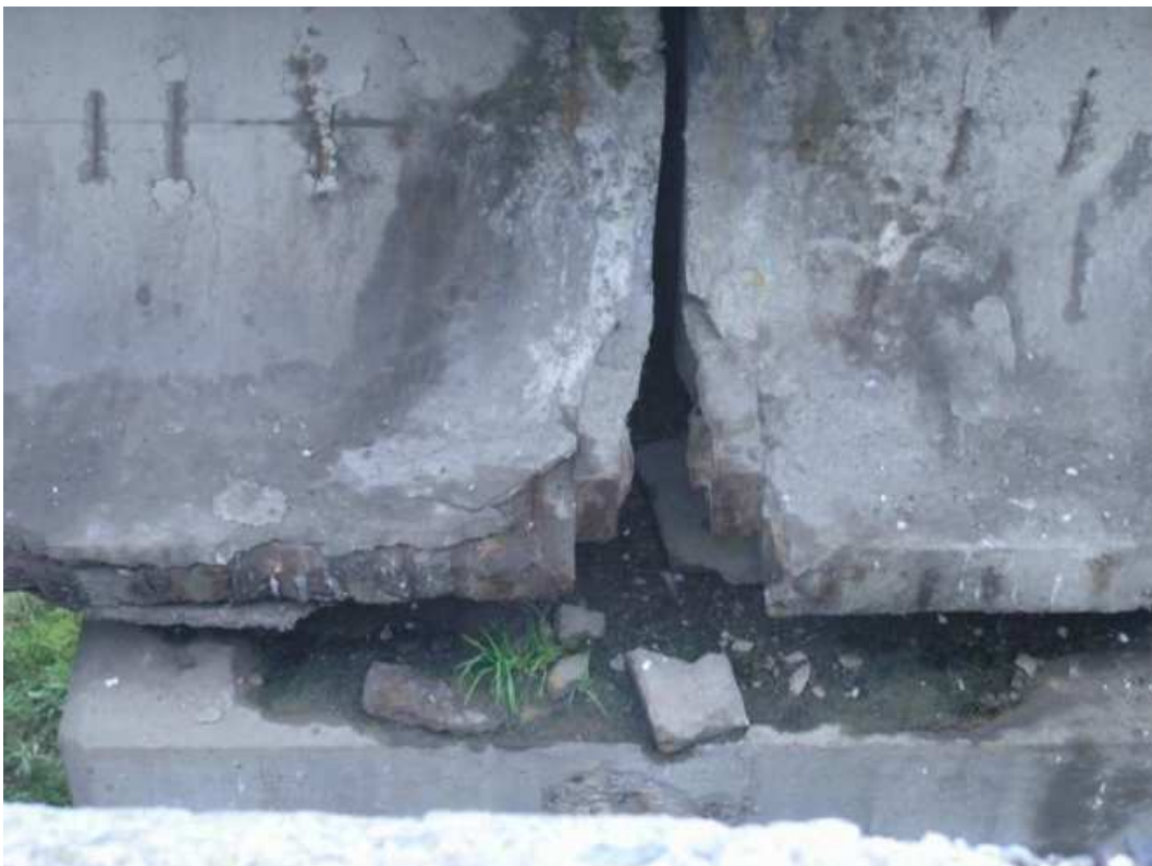
Obr. 43 Rozpad betonu dobetonávky kotev.
