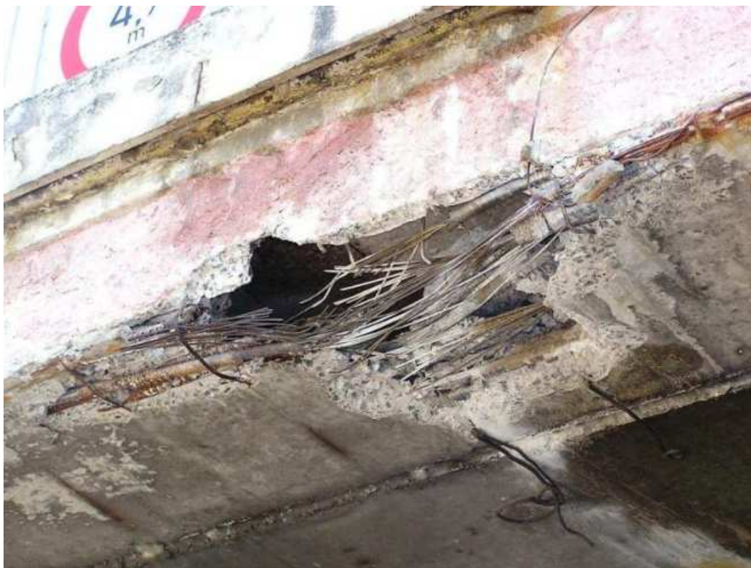
Obr. 58 Náraz vozidla do krajního předpjatého nosníku mostní konstrukce.
