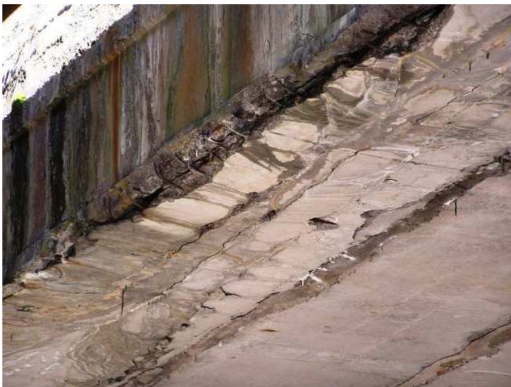
Obr. 18 Podélné trhliny na spodním líci nosníku typu KA.
