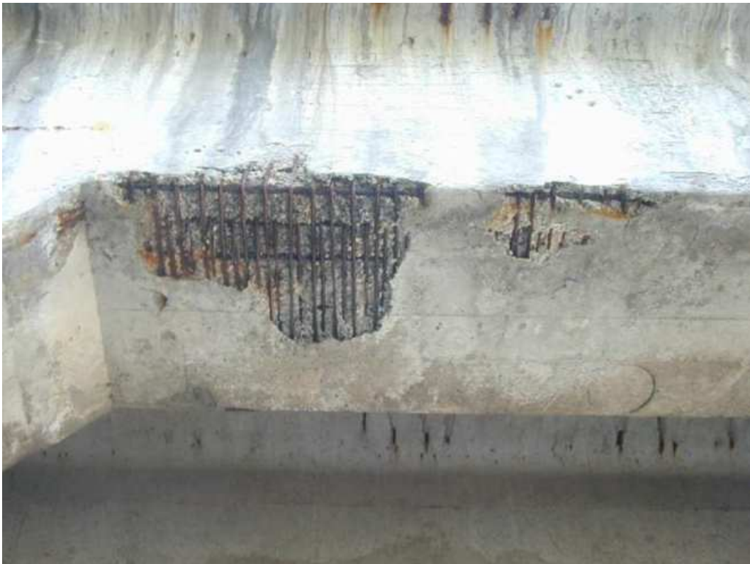
Obr. 46 Separace krycí vrstvy nosníku typu I.
