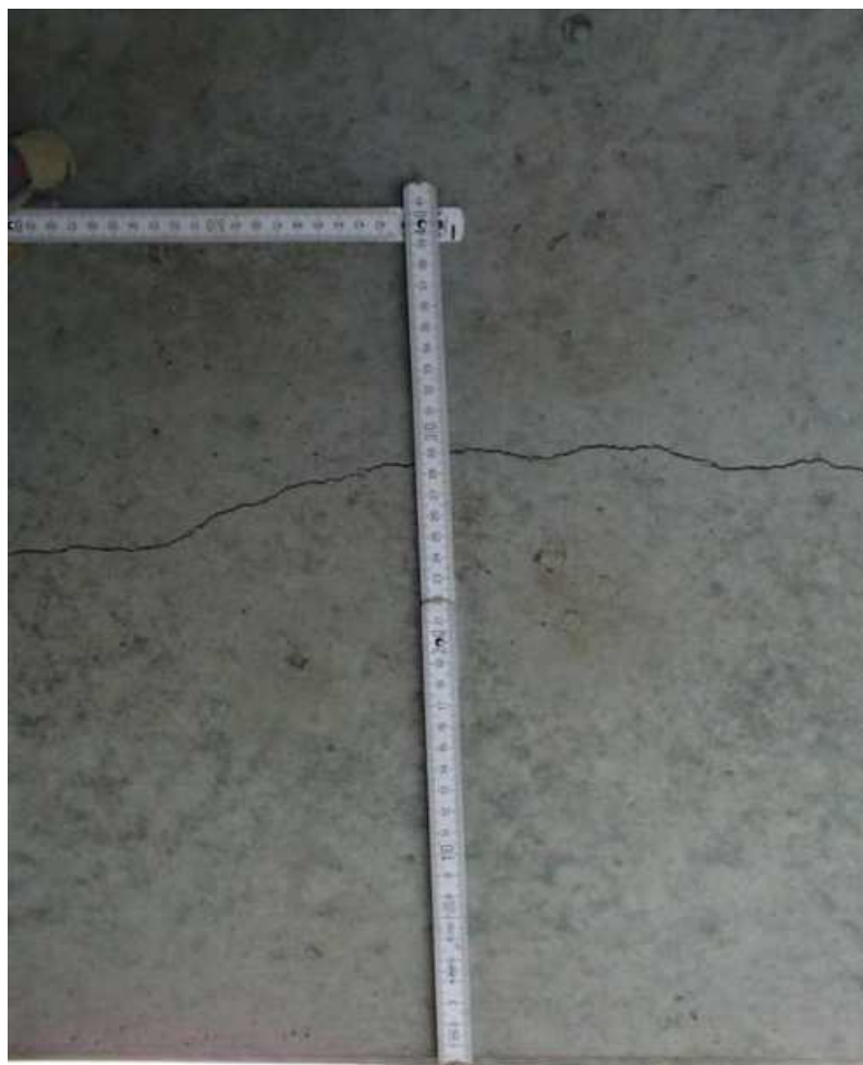
Obr. 24 Šikmá trhlina tloušťky cca 1 mm podél zvedaného předpínacího kabelu ve stojně předpjatého nosníku typu T.
