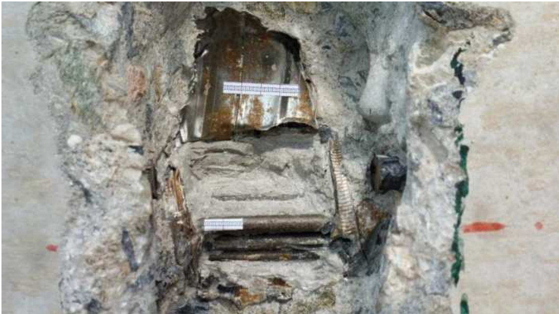
Obr. 6 Pohled do otevřené SDT sondy s odhalenými dráty předpínací výztuže a s vlepenými kalibračními měřítky
