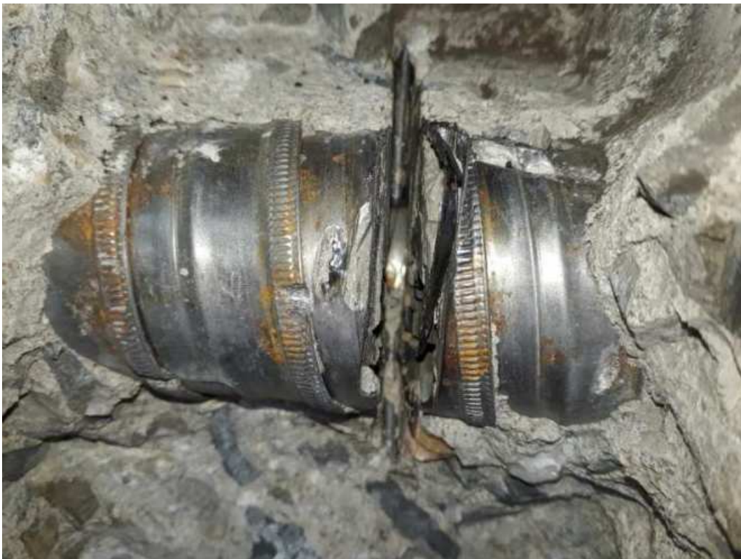
Obr. 47 Místo přerušování kabelu
