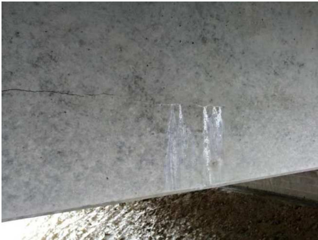
Obr. 25 Pohled na šikmou trhlinu podél zvedaného kabelu s výluhy na bočním líci předpjatého prefabrikovaného nosníku typu T.
