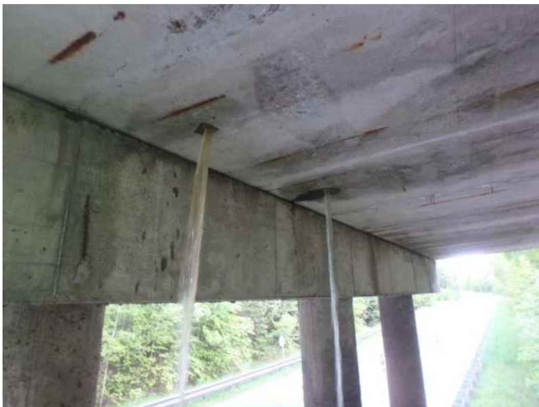
Obr. 52 Odtok vody z dutin prefabrikovaných nosníků po odvrtání sondy skrze spodní desku.
