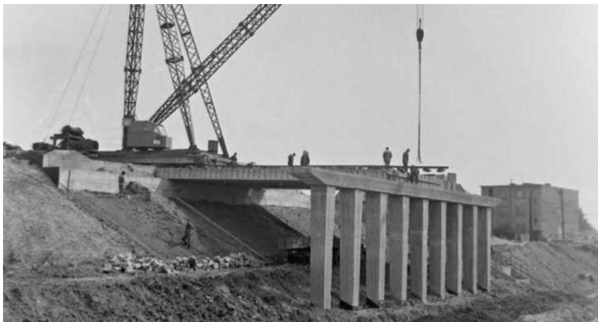
Obr. 14 Použití nosníků KA-61 výšky 0,85 m, most ČS mládeže v Ostravě, dnešní ulice Plzeňská, výstavba mostu 60. léta (Demolice a výstavba nového mostu proběhla v roce 2017). Zdroj: www.betontks.cz
