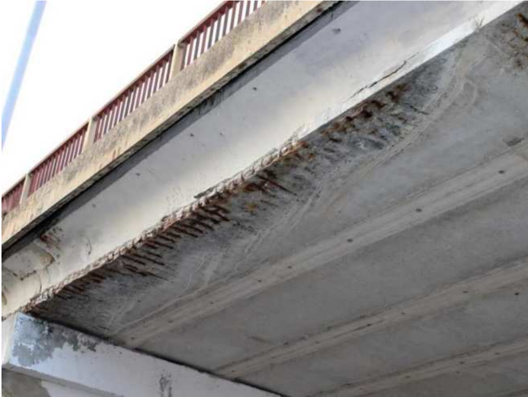
Obr. 45 Pohled na odpadnou betonovou krycí vrstvu a na obnaženou betonářskou výztuž předpjatého tyčového prefabrikátu typu I (nejčastěji I-67, I-73).
