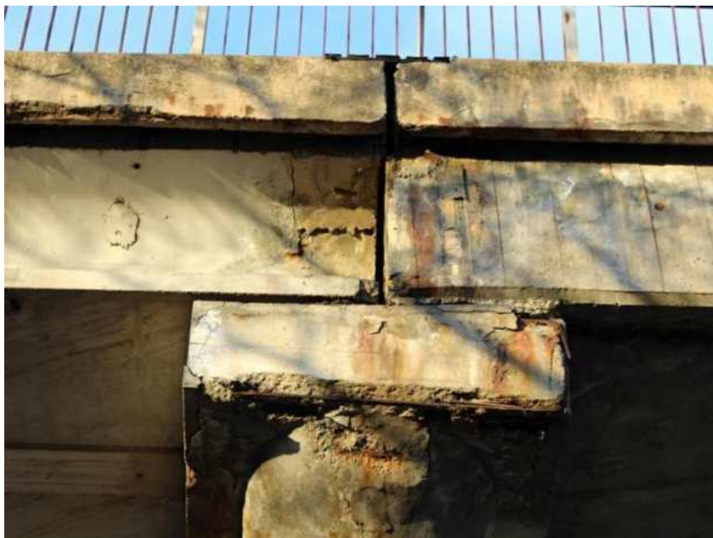
Obr. 11 Na fotografii je zachycena silně zatečená dobetonávka kotevní oblasti skrze dilatační spáru (na obrázku levý nosník). Dochází již k odpadu betonu a oddělování dobetonované části trhlinou od čela nosníku.
