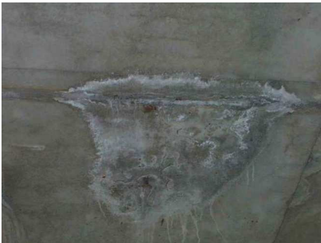
Obr. 8 Na obrázku je zobrazena zatečená příčná spára mostu složeného z tyčových prefabrikátů (v ČR nejčastěji typ KA a I). V okolí spáry jsou viditelné mapy po zatékání, vápenité povlaky a také korozivní výluhy (hnědé skvrny na povrchu betonu).
