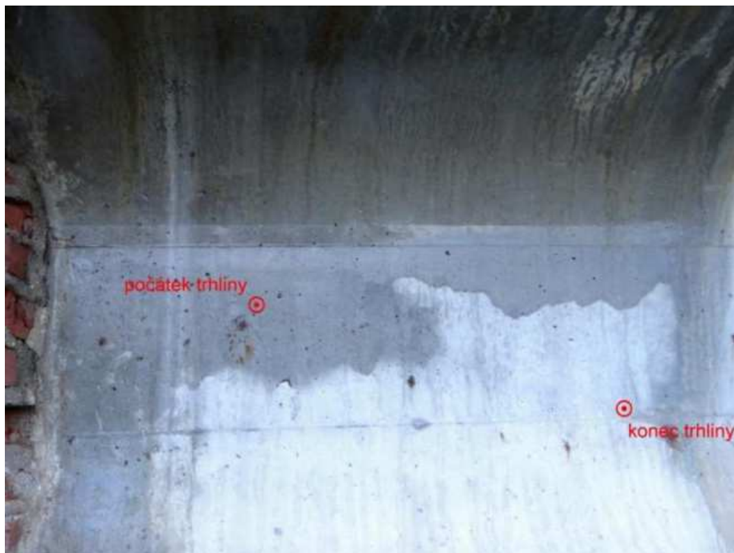
Obr. 22 Šikmá trhlina tloušťky cca 0,1 mm podél zvedaného předpínacího kabelu ve stojně prefabrikovaného nosníku typu I-73.
