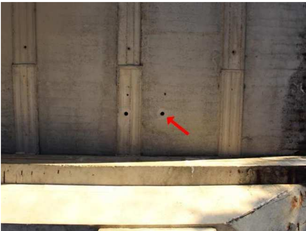
Obr. 61 Pohled na nezapravené sondážní otvory. Vpravo sondážní otvor k předpínací výztuži nosníku typu I (nejčastěji I-67, I-73).
