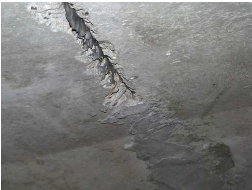
Obr. 60 Lokální mechanické poškození, které pravděpodobně vzniklo již při výrobě nosníku.
