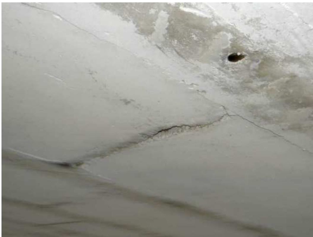
Obr. 59 Pohled na porušenou příčnou spáru mezi prefabrikovanými nosníky typu I. Lokální mechanické poškození pravděpodobně vzniklo již při výrobě nosníku např. při vytahování z formy.
