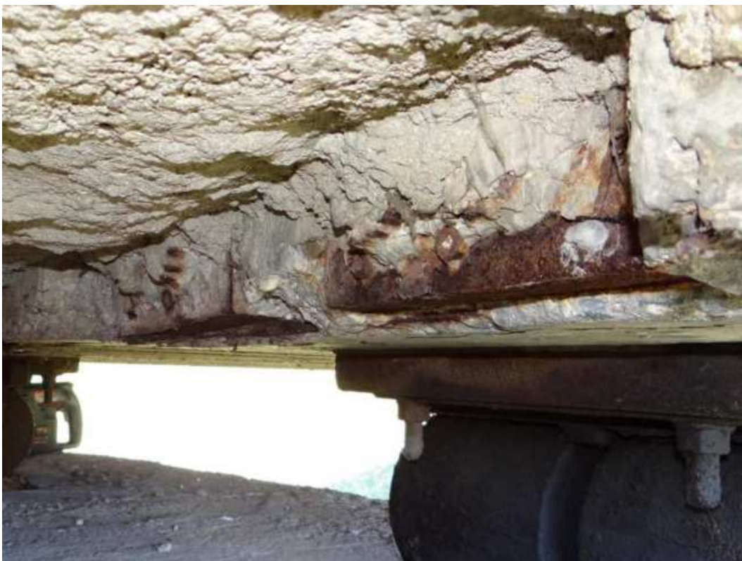
Obr. 41 Pohled na odhalené kotvy po odpadu dobetonávky kotevní oblasti u prefabrikovaných nosníků typu I (nejčastěji I-67, I-73). Kotvy jsou zasaženy korozí.
