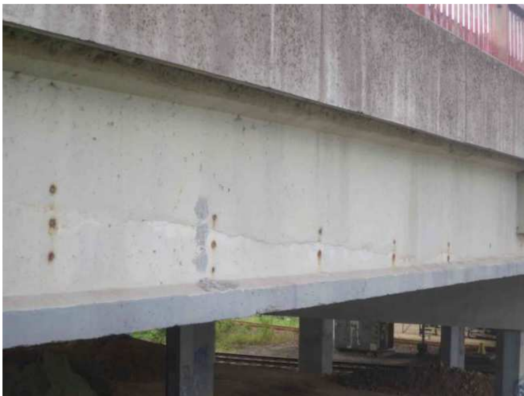
Obr. 23 Šikmá trhlina na bočním líci předpjatého mostu
