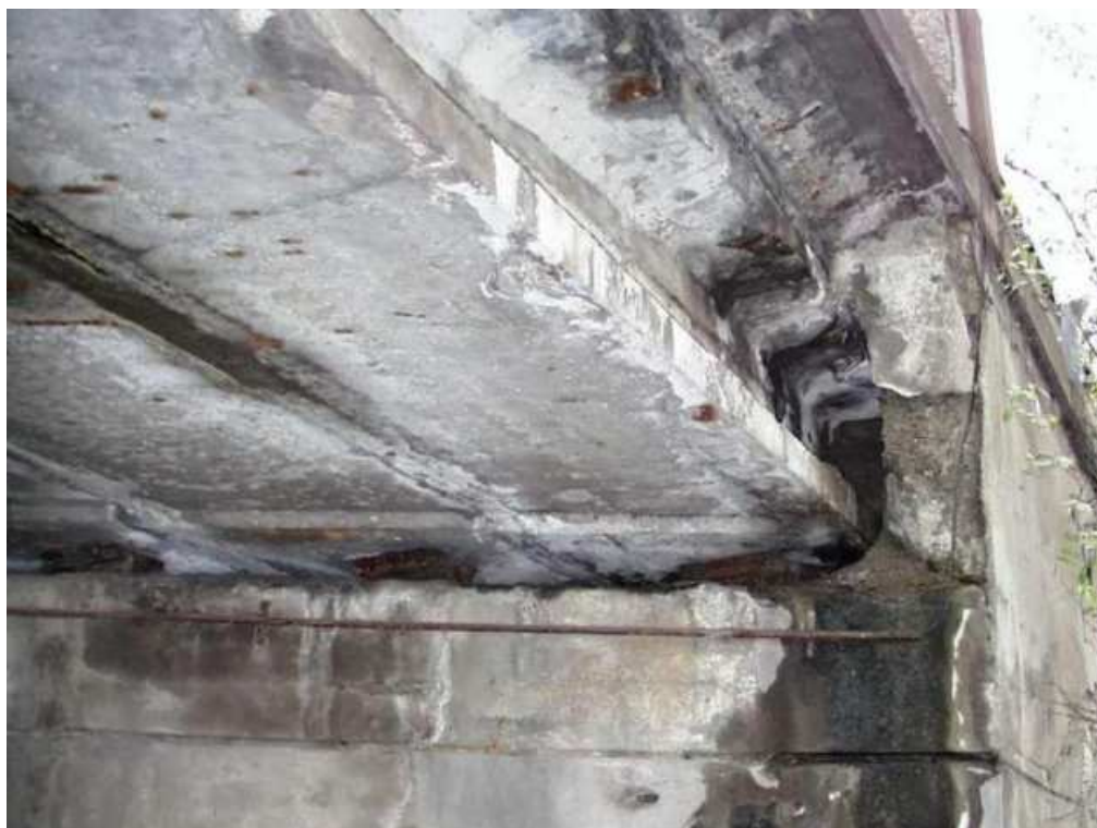
Obr. 12 Silně poškozená nosná konstrukce složená z prefabrikátů v oblasti uložení vlivem zatékání skrze dilatační spáru mostního závěru.
