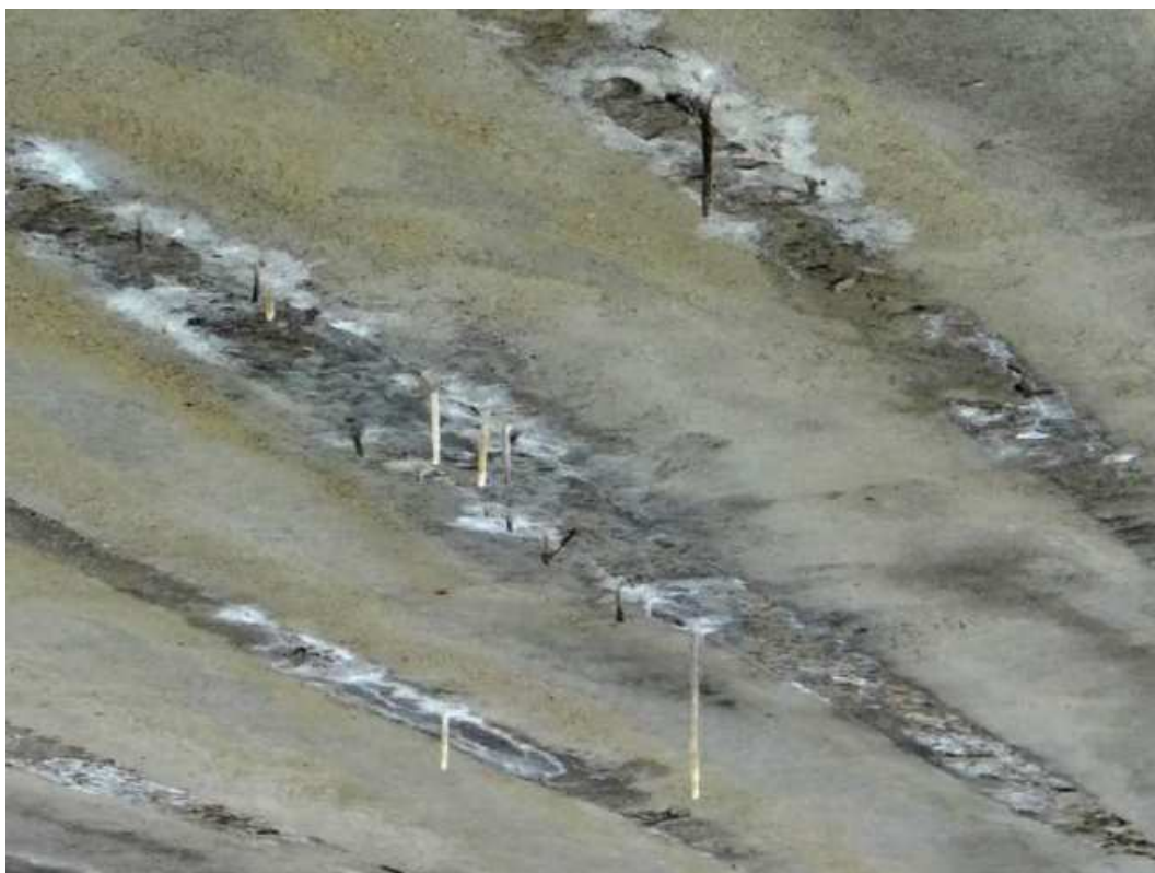
Obr. 4 Na obrázku jsou zobrazeny zatečené podélné spáry s krápníky mostu složeného z prefabrikovaných předpjatých nosníků (v tomto případě jde o prefabrikáty typu MPN „Fousáče“).
