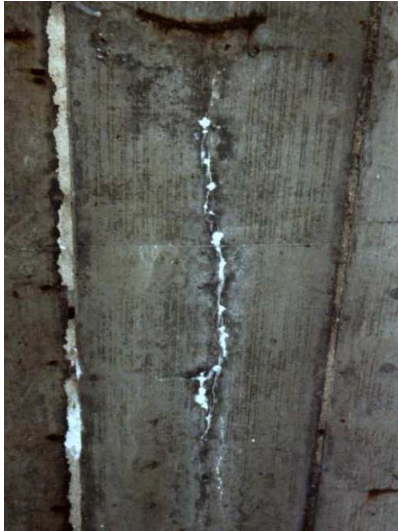
Obr. 29 Pohled na podélnou trhlinu podél trajektorie předpínací výztuže (nezainjektovaný kanálek) s výluhy na spodním líci předpjatého prefabrikovaného nosníku typu KA.
