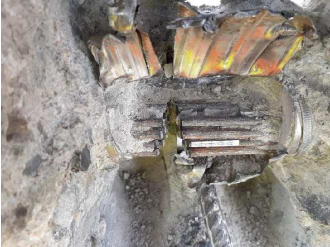
Obr. 48 Místo přerušení kabelu – přerušovací sonda (výsledný V tvar řezu)
