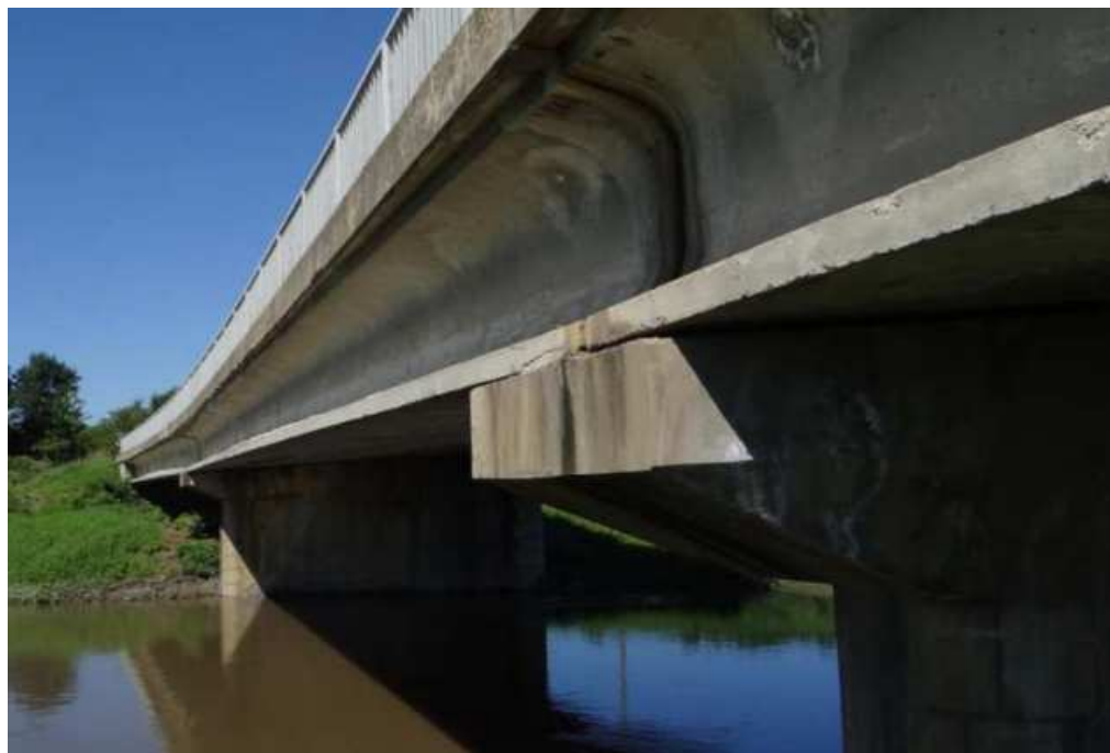
Obr. 4 Pohled na krajní nosníky I-62, výrazné vzepětí středního pole
