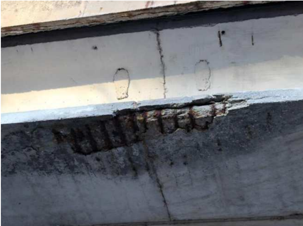
Obr. 44 Pohled na odpadanou betonovou krycí vrstvu na obnaženou betonářskou výztuž předpjatého tyčového prefabrikátu typu I (nejčastěji I-67, I-73).
