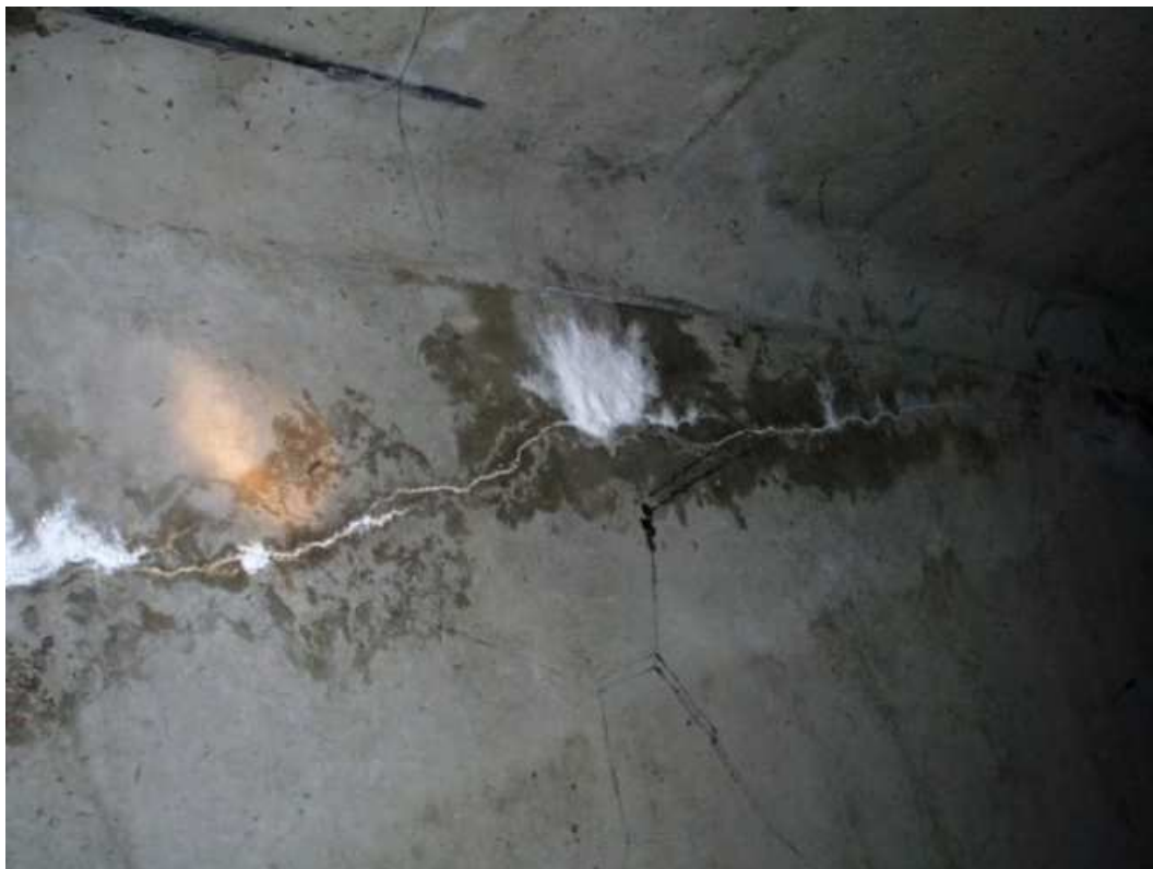
Obr. 26 Pohled na šikmou trhlinu podél zvedaného kabelu s výluhy na bočním líci předpjatého prefabrikovaného nosníku typu T.
