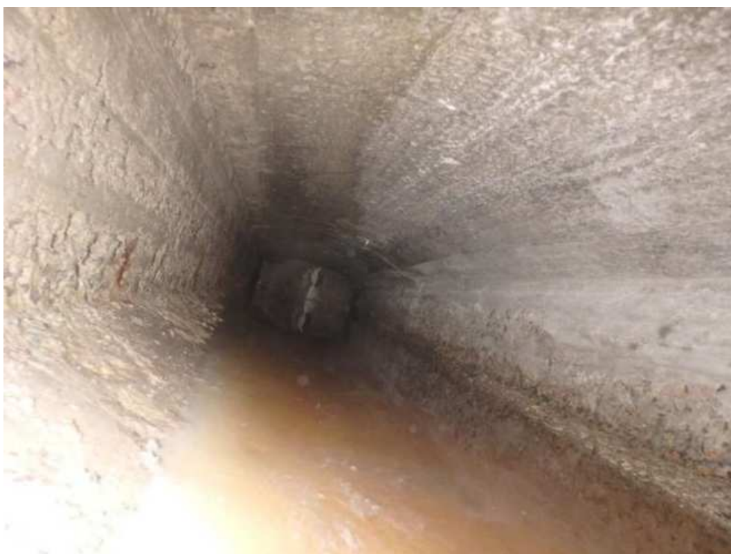
Obr. 51 Pohled do zaplavené dutiny nosníku typu KA.
