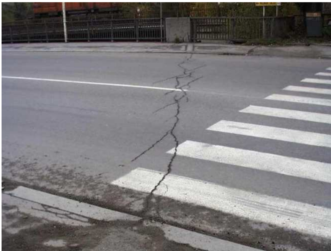
Obr. 30 Pohled na širokou příčnou trhlinu ve vozovce mostovky nad opěrou mostu.
