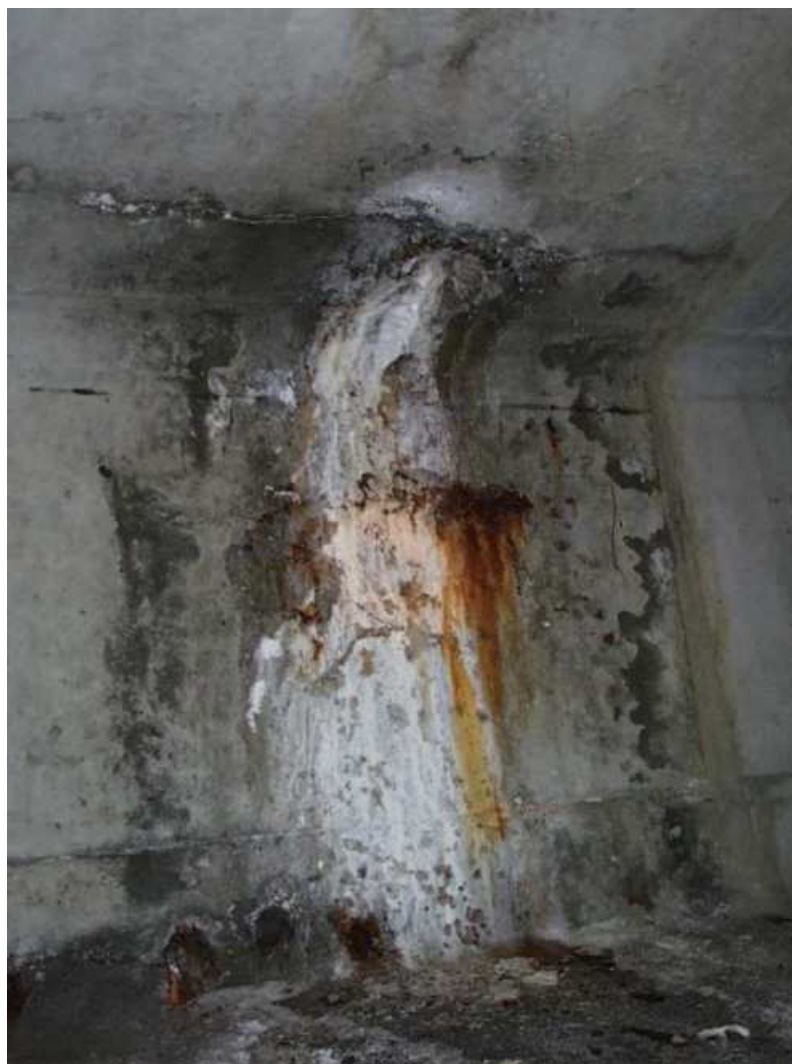
Obr. 16 Pohled na místo s vytékajícími korozními zplodinami (hnědé až oranžové zbarvení).
