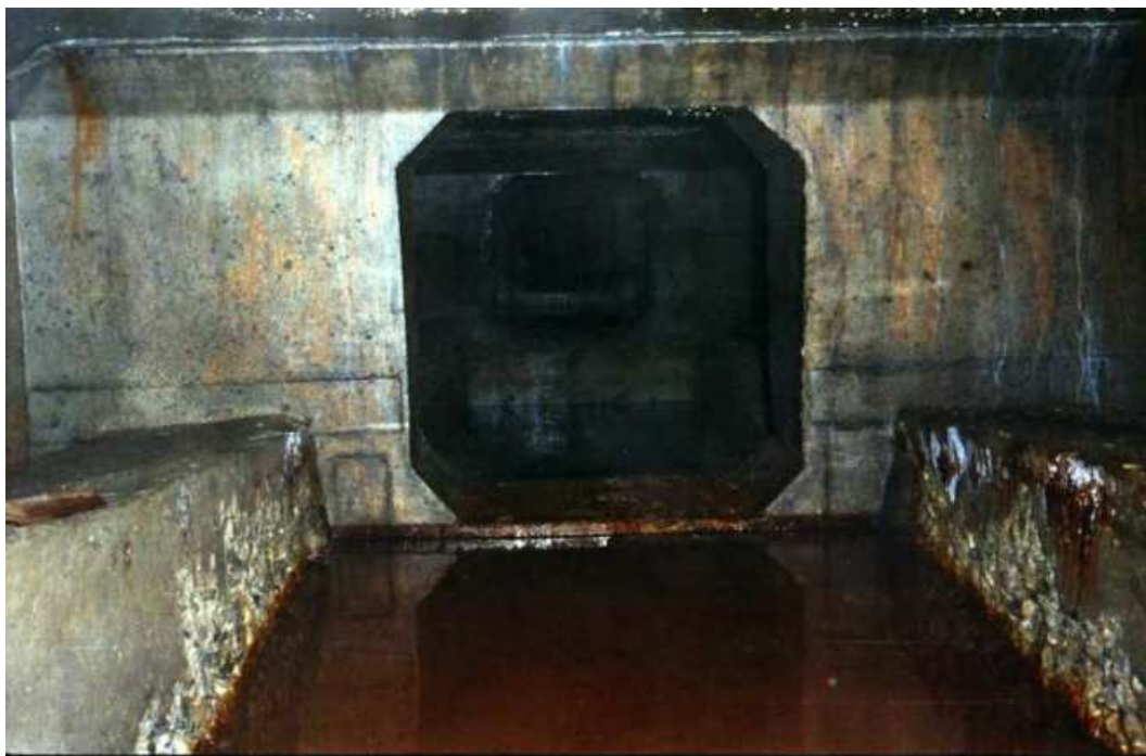
Obr. 55 Vodou zaplavená komora komorového mostu.
