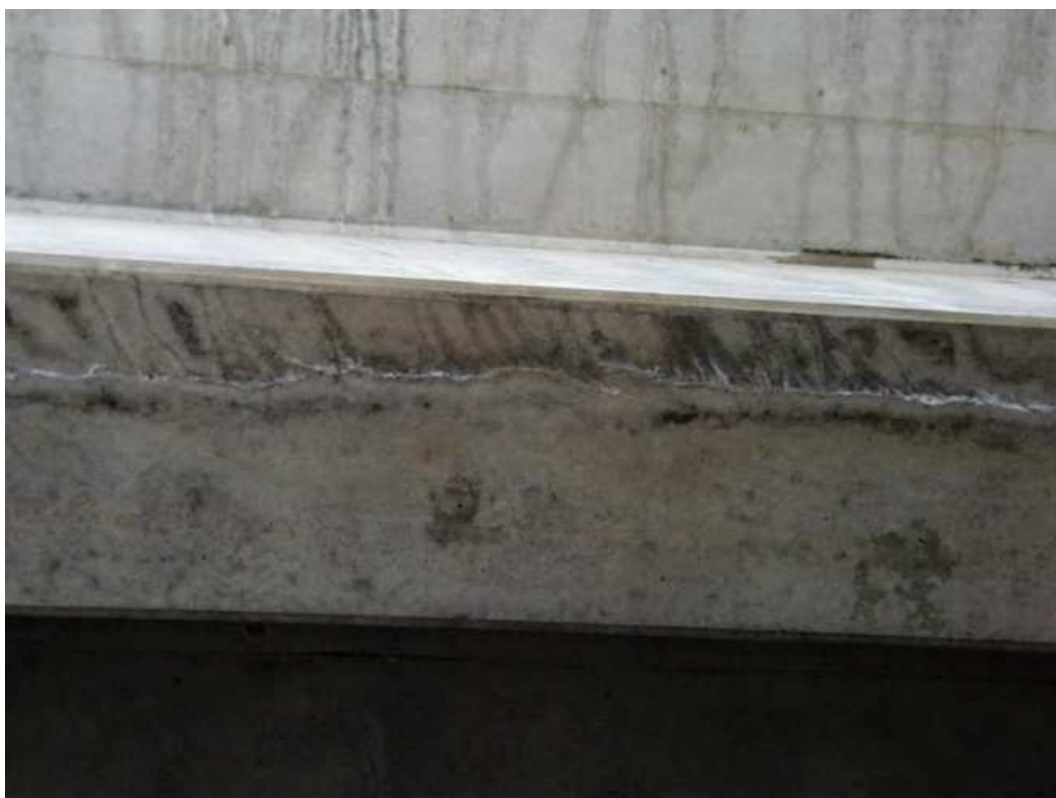
Obr. 27 Pohled na podélnou trhlinu podél trajektorie předpínací výztuže s výluhy na spodním líci předpjatého prefabrikovaného nosníku typu T.
