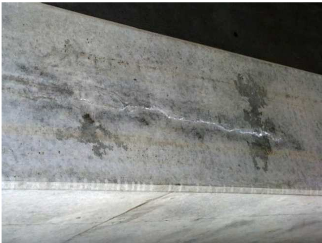
Obr. 28 Pohled na podélnou trhlinu podél trajektorie předpínací výztuže s výluhy na spodním líci předpjatého prefabrikovaného nosníku typu T.
