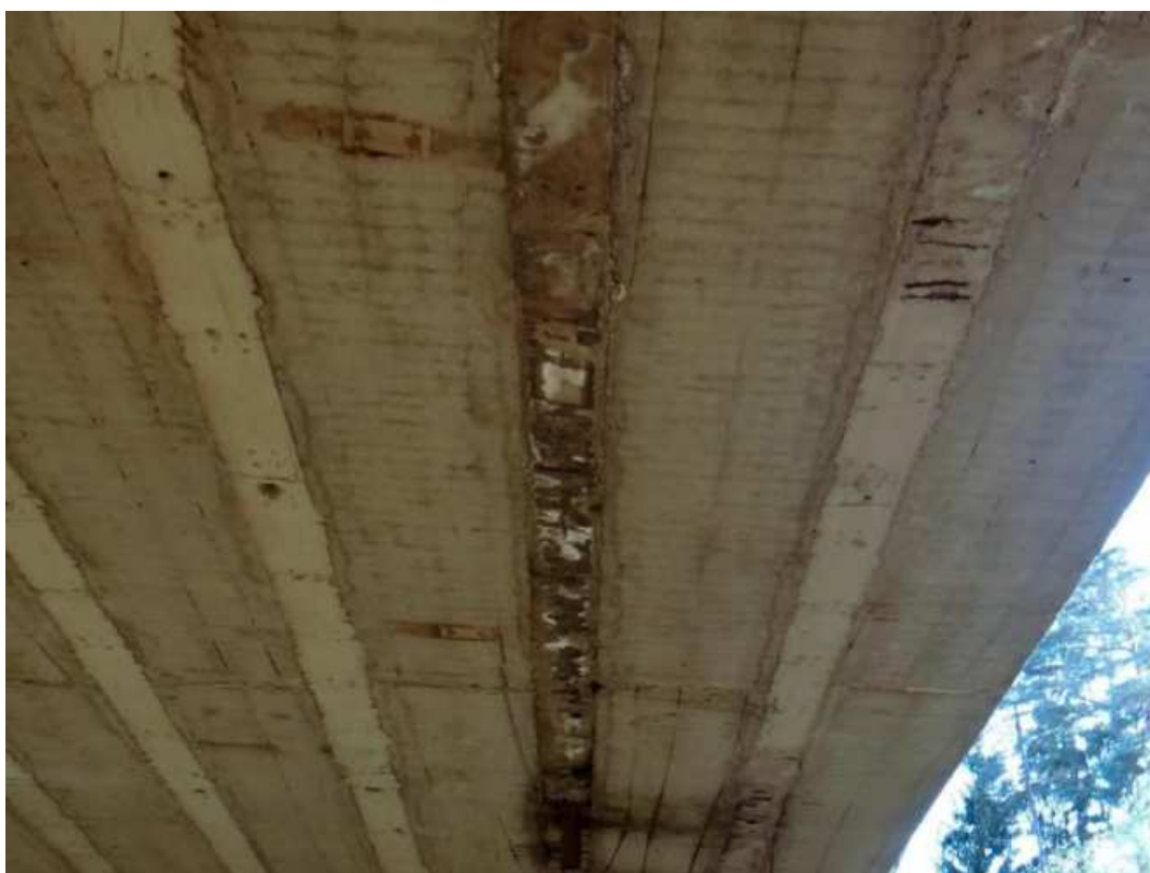
Obr. 6 Na obrázku je zobrazen typický projev závady – viditelně zatečená podélná spára (změna zabarvení dobetonávky spáry). Závada je často doprovázena výluhy, povlaky i krápníky. Závadu lze pozorovat u mostů z tyčových prefabrikovaných nosníků (nejčastěji typ KA, I).
