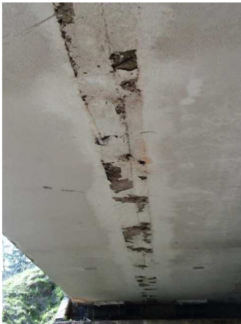
Obr. 7 Viditelně zatečená podélná spára mostu z tyčových předpjatých prefabrikátů. V případě, kdy je most opatřen nátěrem, lze pozorovat odlupující se vrstvy nátěru podélné spáry a také stopy (světlé mapy) po zatékání.
