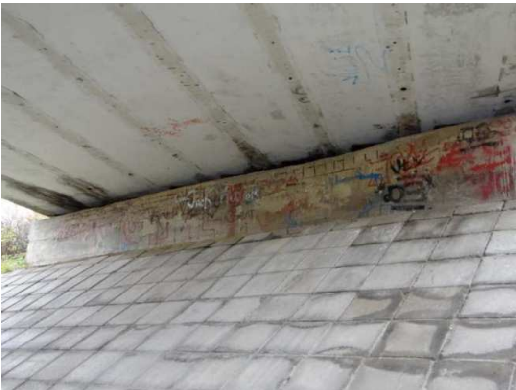
Obr. 10 Na obrázku jsou zřetelně vidět vlhká místa (tmavé zbarvení povrchu) v oblasti uložení prefabrikovaných nosníků.
