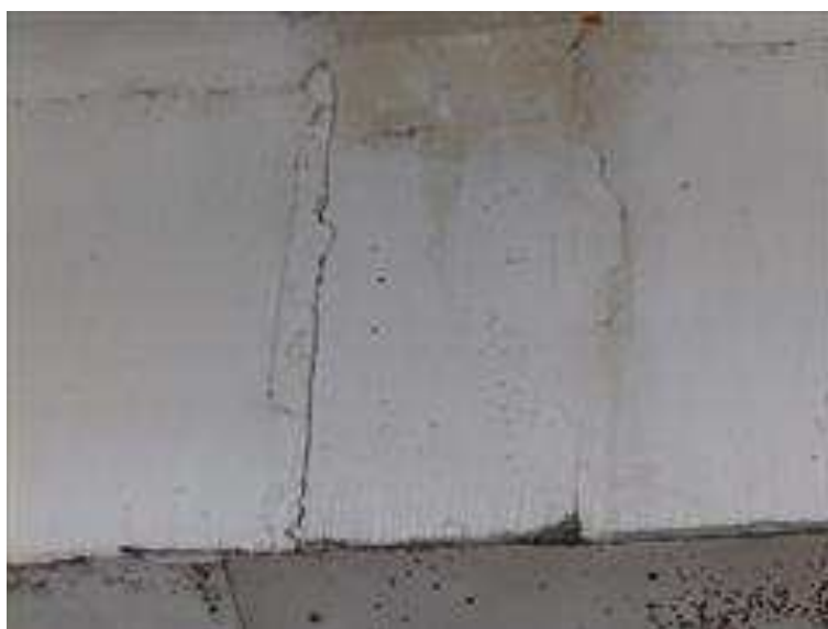
Obr. 20 Příčná trhlina mezi segmenty.
