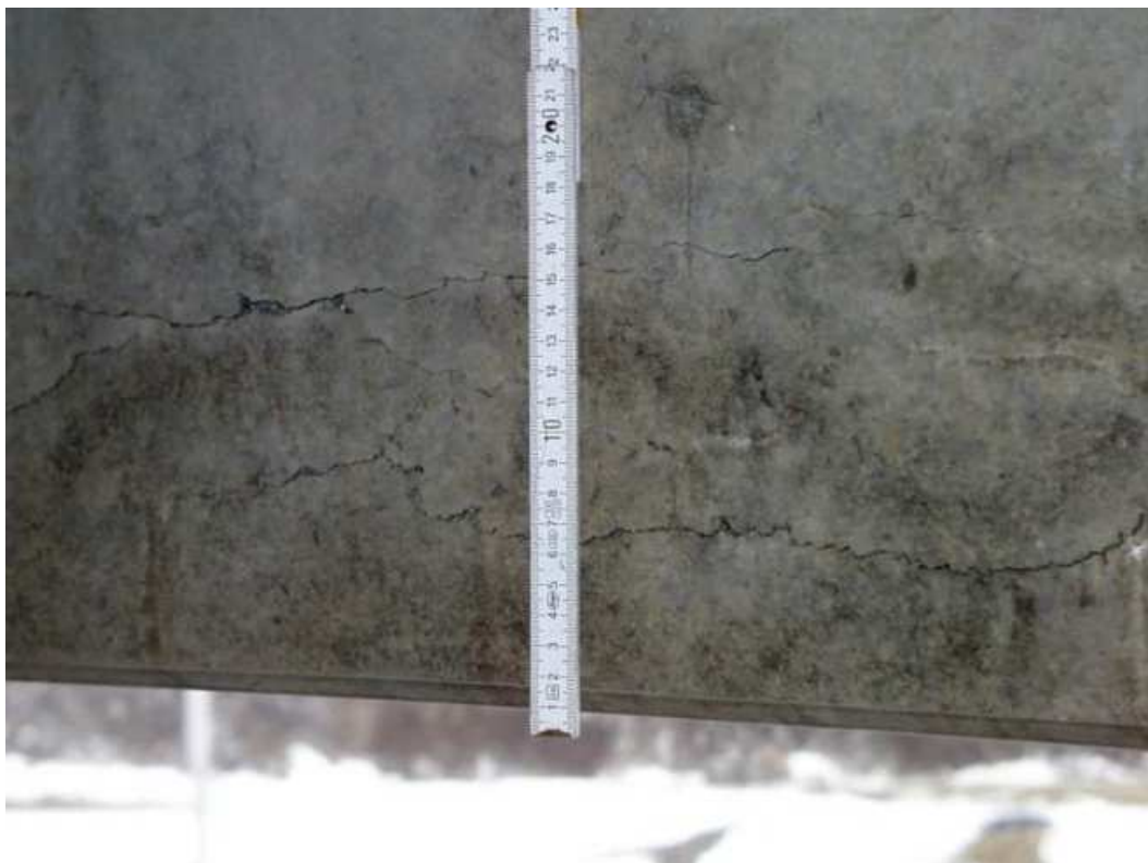
Obr. 34 Síť trhlin na bočním líci prefabrikovaného nosníku cca 6–10 cm od spodního líce betonu, u kterého je vedena předpínací výztuž.
