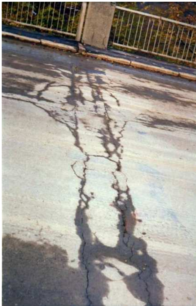
Obr. 33 Příčné trhliny ve vozovce nad středním pilířem mostu.
