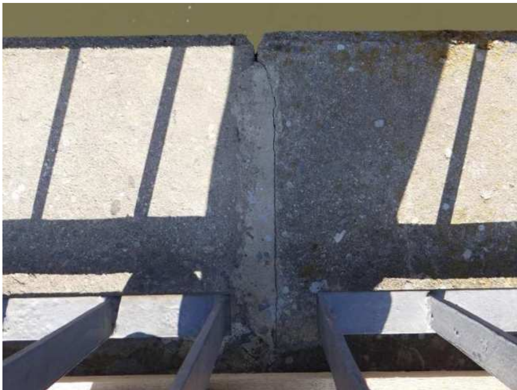
Obr. 21 Pohled na příčnou trhlinu v dobetonované spáře mezi předpjatými segmenty typu DS-L.
