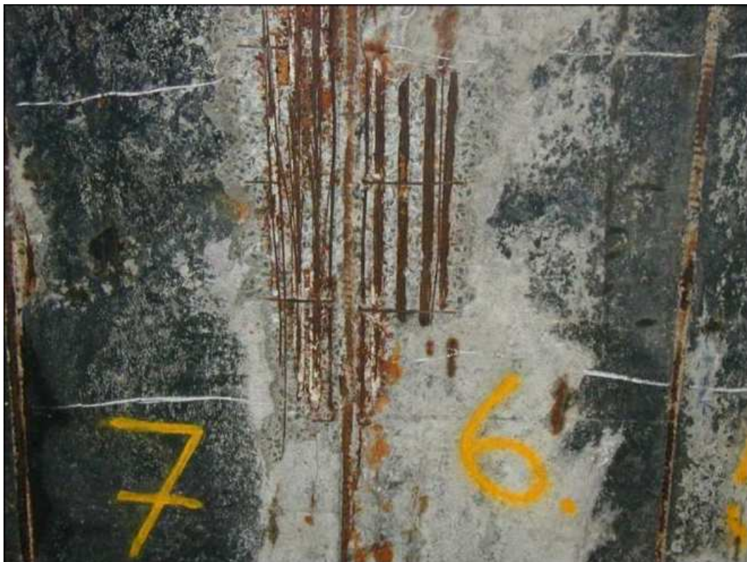
Obr. 48 Obnažené předpínací kabely při spodním líci.
