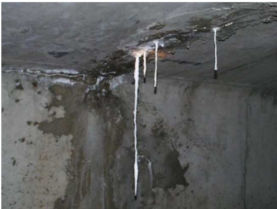
Obr. 5 Vápenité krápníky uvnitř předpjatého komorového nosníku v místě zatékání (příčná spára).
