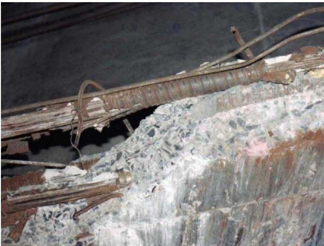
Obr. 57 Pohled na deformaci dolní příruby nosníku typu I po nárazu vozidla.
