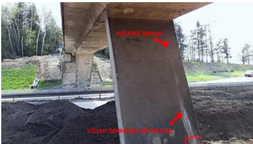
Obr. 35 Svislá trhlina ve stěnové podpěře mostní konstrukce
