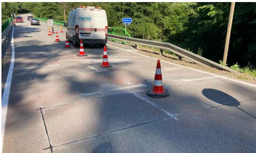
Obrázek 2: Senzory vážního systému instalované ve vozovce (indukční smyčky a nápravové senzory)
