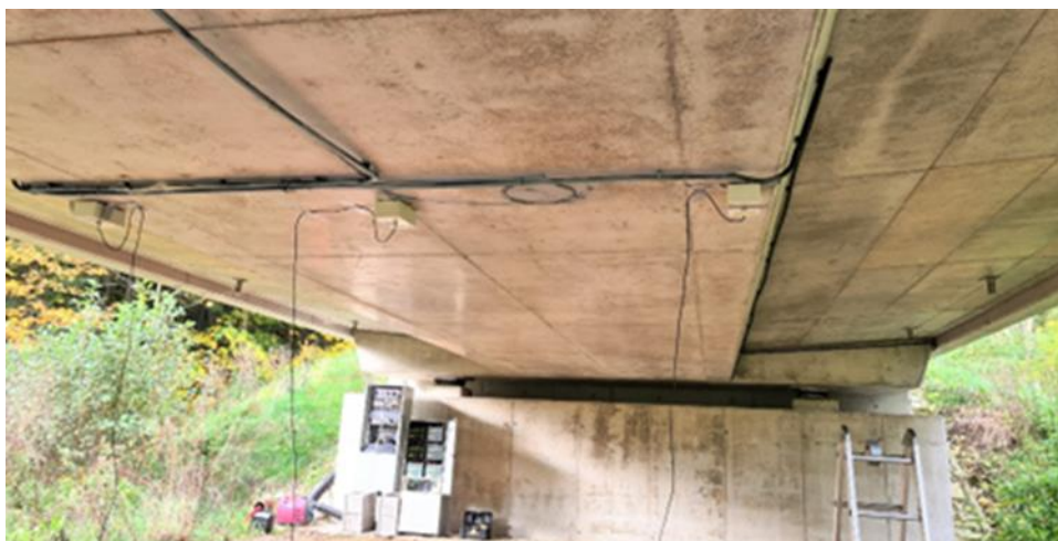
Obr. 13Příklad možného osazení akcelerometrů STEVAL na stávající mostní konstrukci, v pozadí skříň elektronika WIM, záznamová a vyhodnocovací jednotka a bateriový systém napájení
