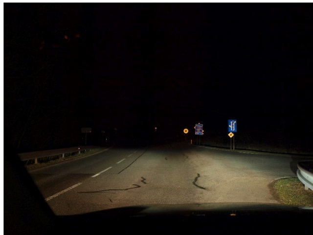
Obr.5 špatně viditelný prostor hrany křižovatky kom. I. a II. tř. absence vodorovného dopravního značení
